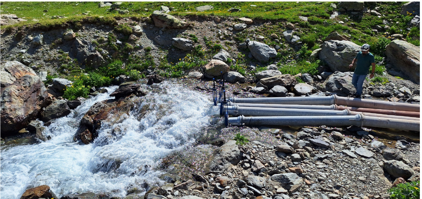
Rejet aval des lignes de siphonnage.
